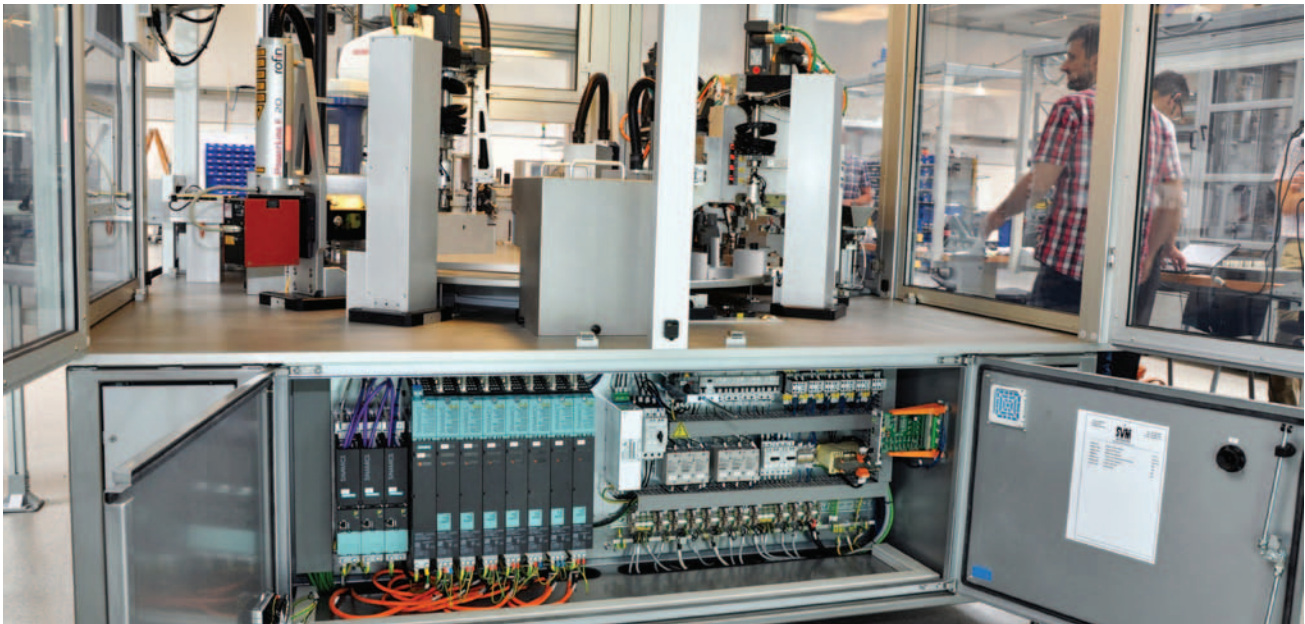
Celle 3 med rundbordet øverst og styringen i tavlen nedenunder. For at forenkle reservedelslageret på fabrikken i Asien er der såvidt muligt brugt de samme servodrev, PLC'er og andre enheder til de forskellige funktioner.
